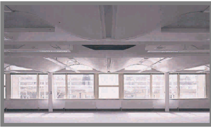
Şekil 3. Dalgalı döşeme plağı görüntüsü.
